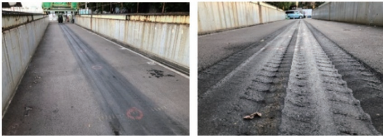
写真-3 路面状況 (20万輪走行後)
