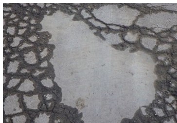
写真-2 補修3カ月後
