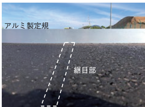
写真－10 舗装端部の段差確認
