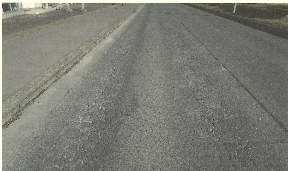
写真 3-1 ひび割れの状況
