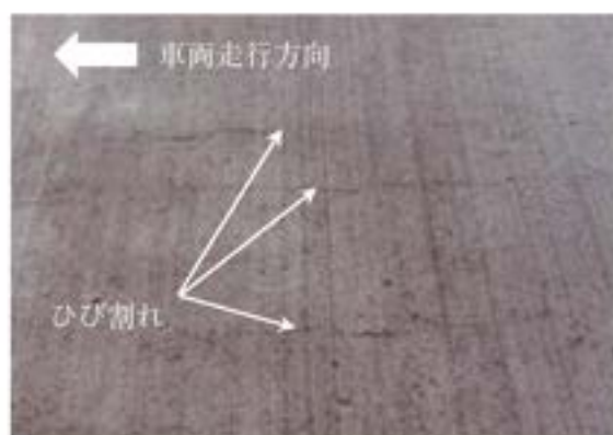
写真4-1 施工中に発生したひび割れ(A)
