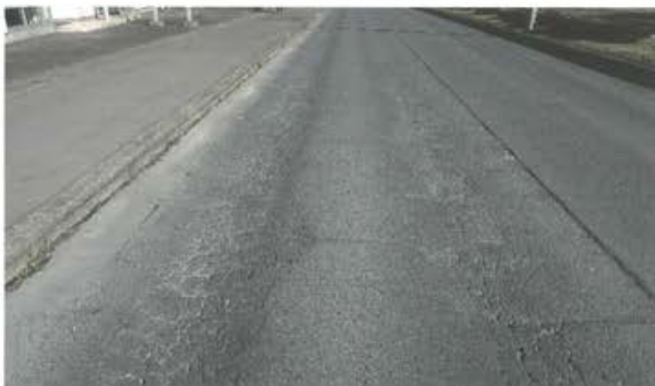
写真3-1 ひび割れの状況
