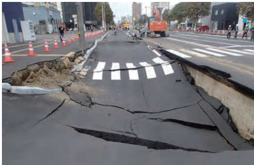
車道部被災状況
