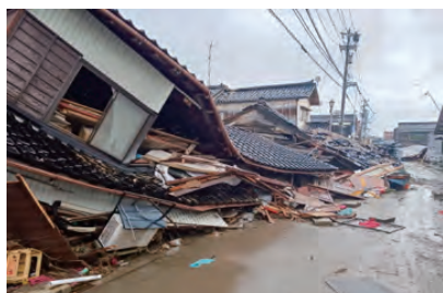
家屋の倒壊(珠州市大谷町)
