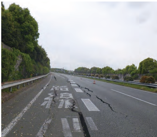
益城バス停付近被災状況
