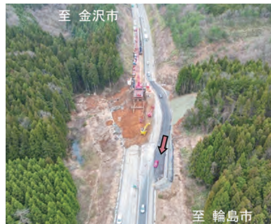
R6.2.2（北向き1車線開放）
