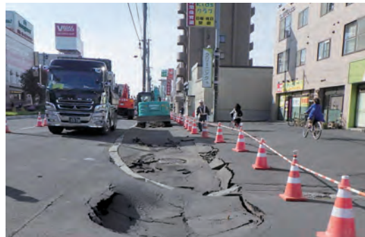
歩道部被災状況
