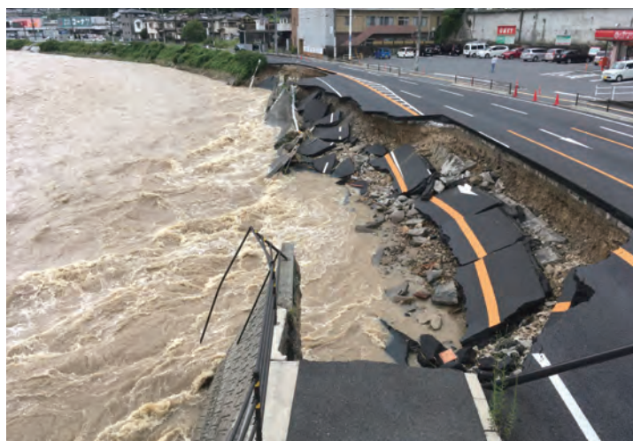
国道2号線被災状況
