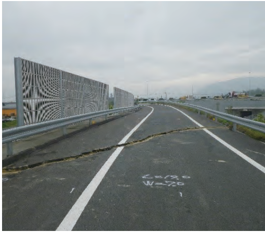
嘉島JCT被災状況
