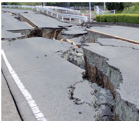
大切畑地区道路破損状況
