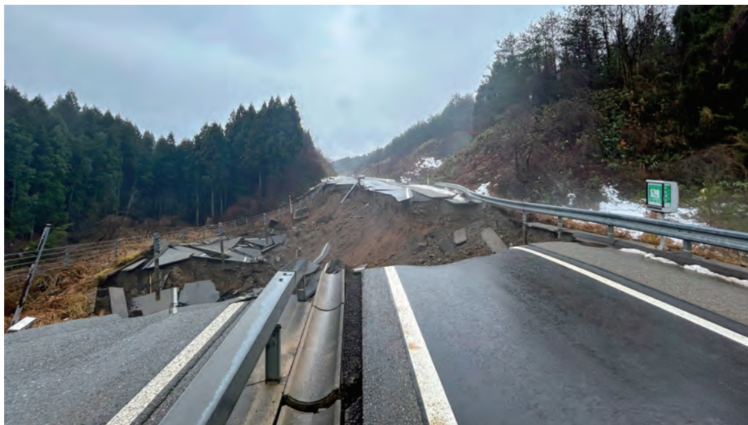
大規模崩壊(能越自動車道(穴水IC～のと里山空港IC 14.1kp))
