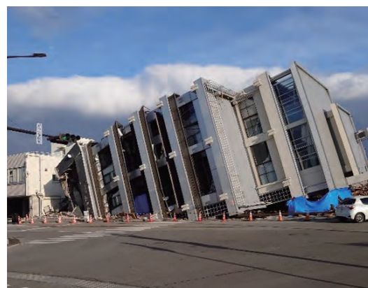
倒壊したビル(輪島市中心部)
