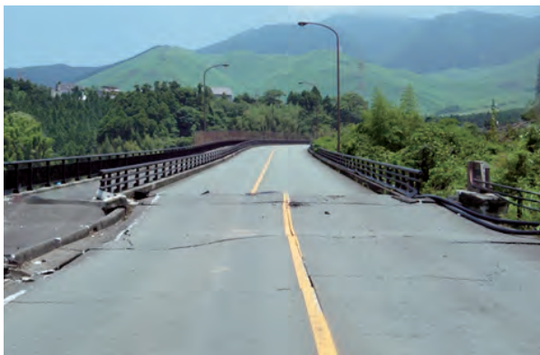
地震直後の大切畑大橋全景(起点側より)
