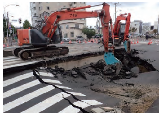
状況写真①：札幌市内、陥没箇所の舗装撤去
