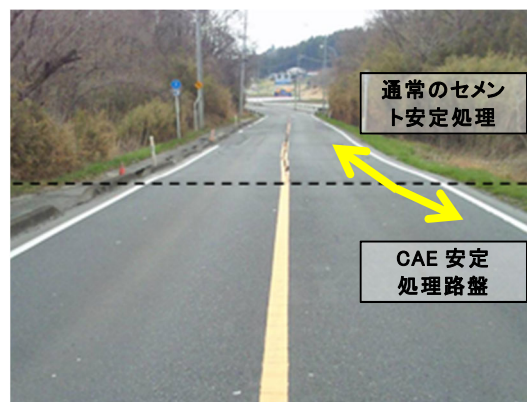
図-9.3 地震後の CAE 安定処理路盤の状況
