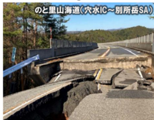
図-1.2 能登半島地震による道路被害 2)
