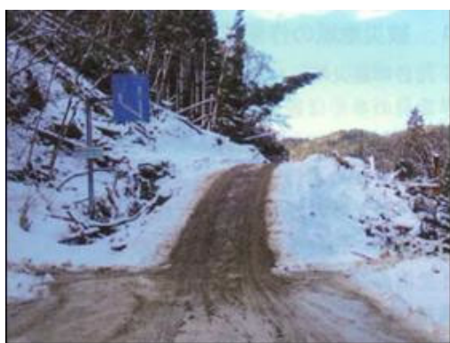
(a) 地山崩壊による仮道路
